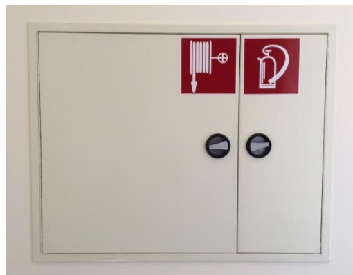
Abb. 4.4.1: Wandhydrantenkasten (hier mit Feuerlöscher kombiniert)
