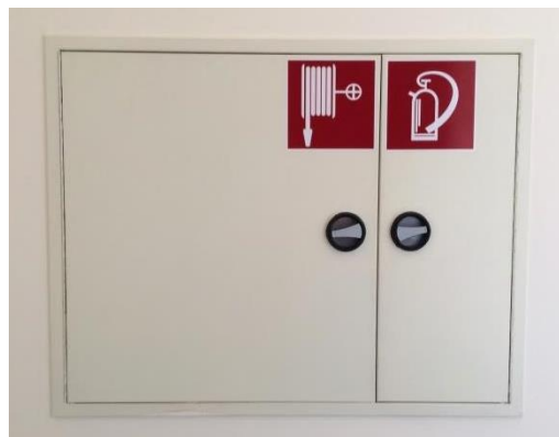
Abb. 4.4.1: Wandhydrantenkasten (hier mit Feuerlöscher kombiniert)
