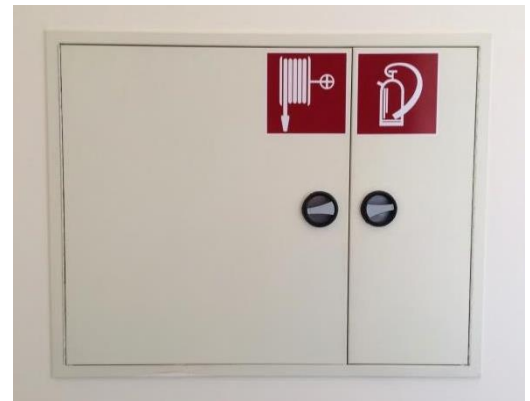
Abb. 4.4.1: Wandhydrantenkasten (hier mit Feuerlöscher kombiniert)
