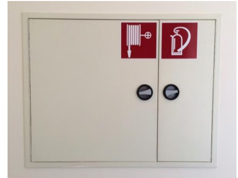
Abb. 4.4.1: Wandhydrantenkasten (hier mit Feuerlöscher kombiniert)
