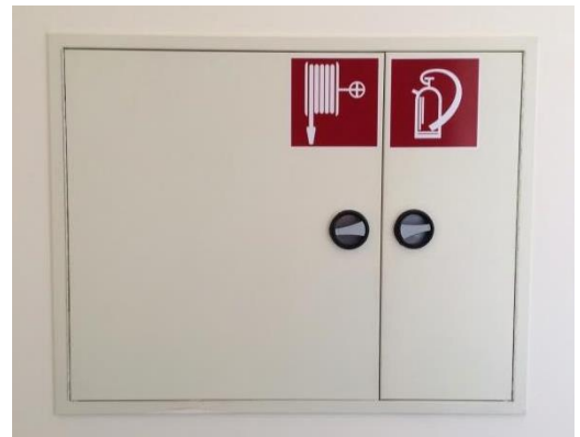
Abb. 4.4.1: Wandhydrantenkasten (hier mit Feuerlöscher kombiniert)
