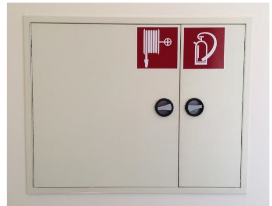
Abb. 4.4.1: Wandhydrantenkasten (hier mit Feuerlöscher kombiniert)
