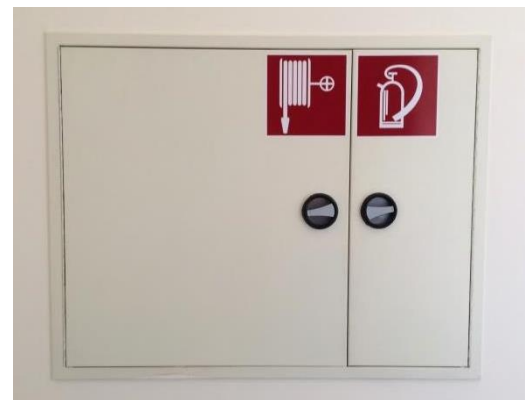
Abb. 4.4.1: Wandhydrantenkasten (hier mit Feuerlöscher kombiniert)
