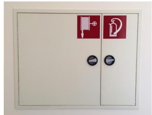
Abb. 4.4.1: Wandhydrantenkasten (hier mit Feuerlöscher kombiniert)
